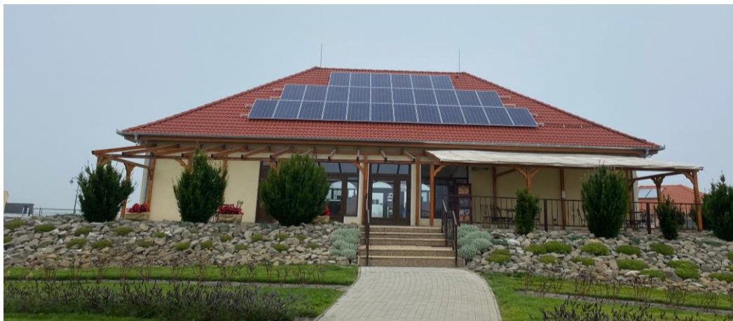
9,38 kWp névleges teljesítményű napelem rendszer
